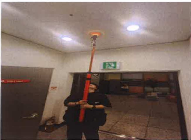
내용: 자동화재탐지설비 동작시험(4)
