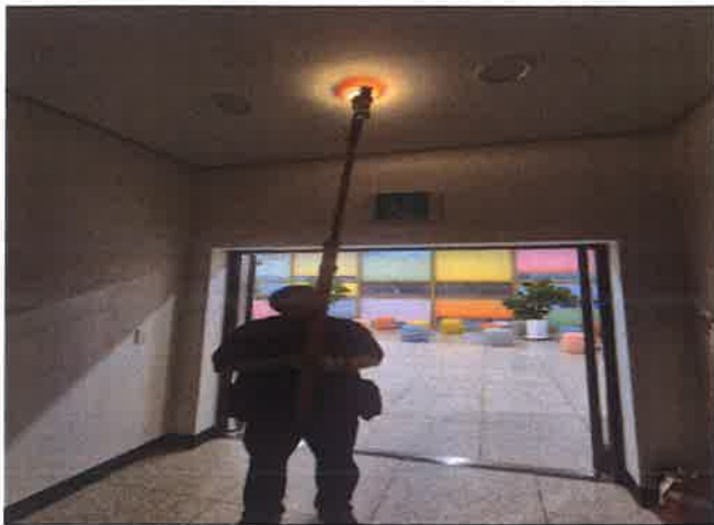
내용: 자동화재탐지설비 동작시험(2)
