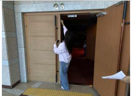
화재상황전파 (발신기 기동 및 출입문 개방)
